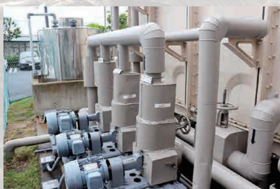
井戸水のろ過設備
